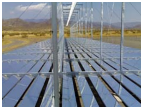
Demonstrationsanlage eines solarthermischen Kraftwerks in Almería, Spanien. Quelle: Fraunhofer ISE.
